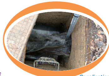
Canalisation d'assainissement collectif
